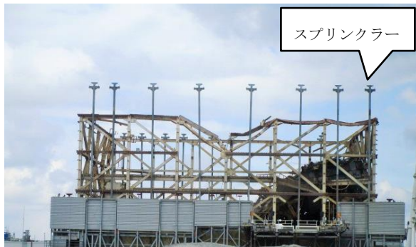
ガレキが剥き出しの1号機建屋
