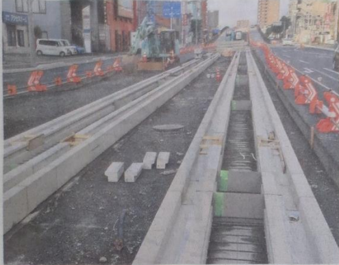
JR宇都宮駅東側で進むLRT軌道敷設工事。一部区間の工期が遅れ、開業が再延期される見通しとなった。27日午後5時35分、宇都宮市東宿郷6丁目
